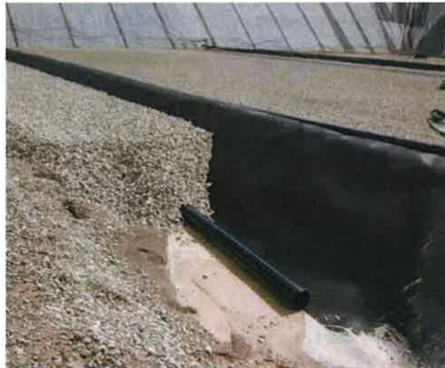
Fig.7 - Tubazione drenaggio percolato
