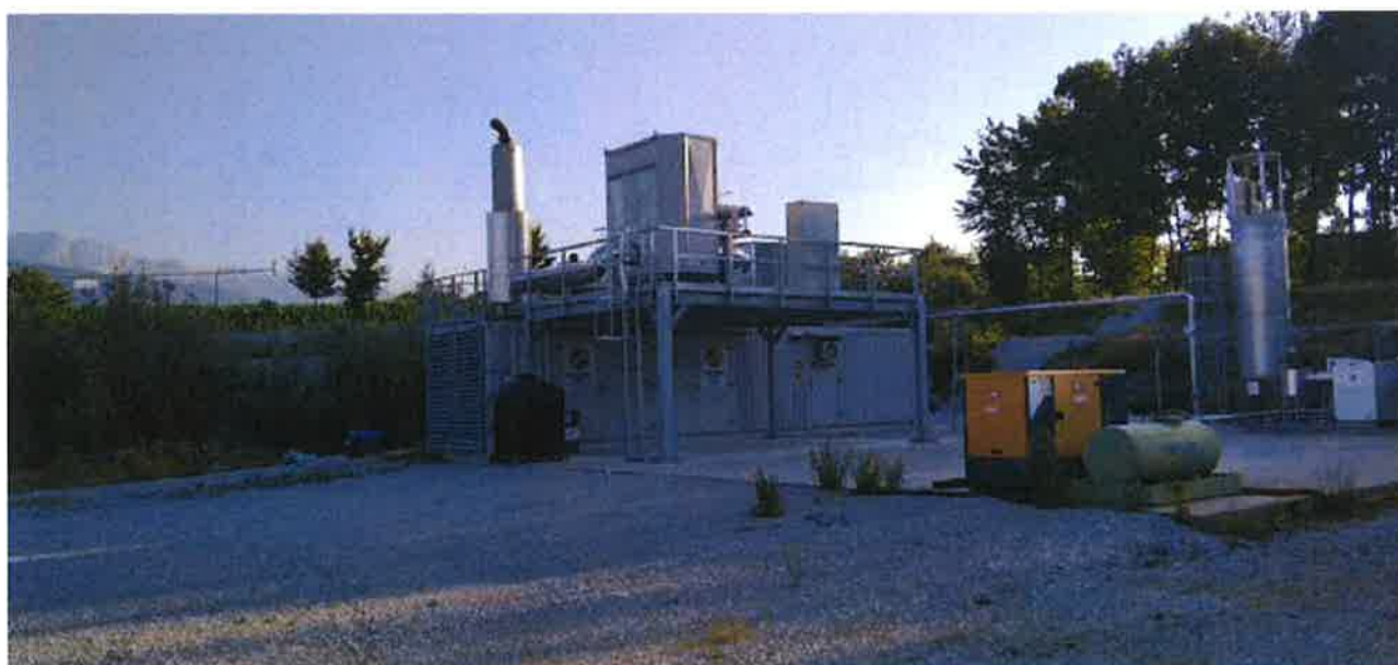
Fig.10 - Impianto di cogenerazione a biogas dotato di post-combustore e torcia
