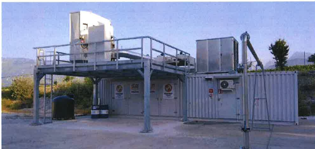
Fig.9 - Impianto di cogenerazione a biogas
